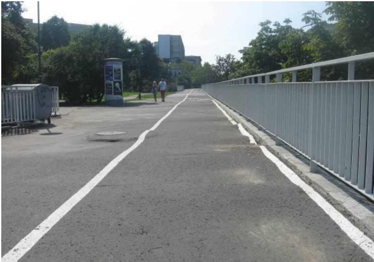
Al. Armii Ludowej/Al. Szucha – zniszczona nawierzchnia drogi dla rowerów
