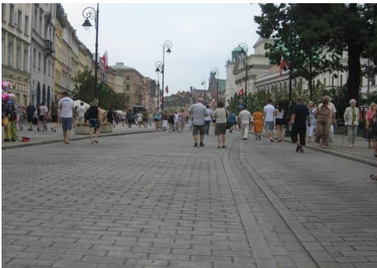
Ul. Krakowskie Przedmieście – trasa 1. Wykonane z kostki ścieki zagłębione około 1cm poniżej poziomu nawierzchni stwarzają (szczególnie zimą, gdy są niewidoczne pod śniegiem) zagrożenie upadkiem przy wjechaniu w nie przednim kołem pod niewielkim kątem. Podobne rozwiązanie można spotkać także w zatoce przystankowej przy pomniku Kopernika oraz na skrzyżowaniu z ul. Królewską i ul. Karową.
