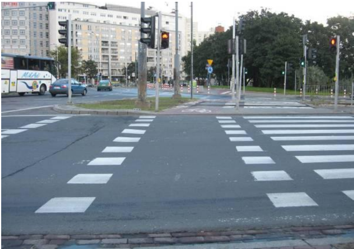
Rondo Zgrupowania AK „Radosław”/ul. Okopowa – trasa 5. Niedokładnie obniżone krawężniki i stosowanie rowków odwadniających wzdłuż krawężnika są w Warszawie bardzo częste.
