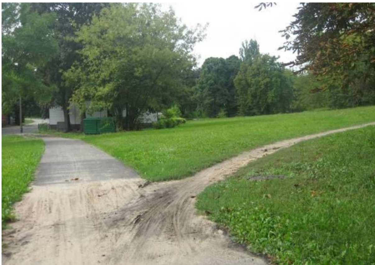
Most Gdański/ul. Wenedów – trasa 1. Brak połączenia drogi dla rowerów na dolnym poziomie mostu z ul. Międzyparkową skłania rowerzystów do jazdy po nasypie a dalej chodnikiem.
