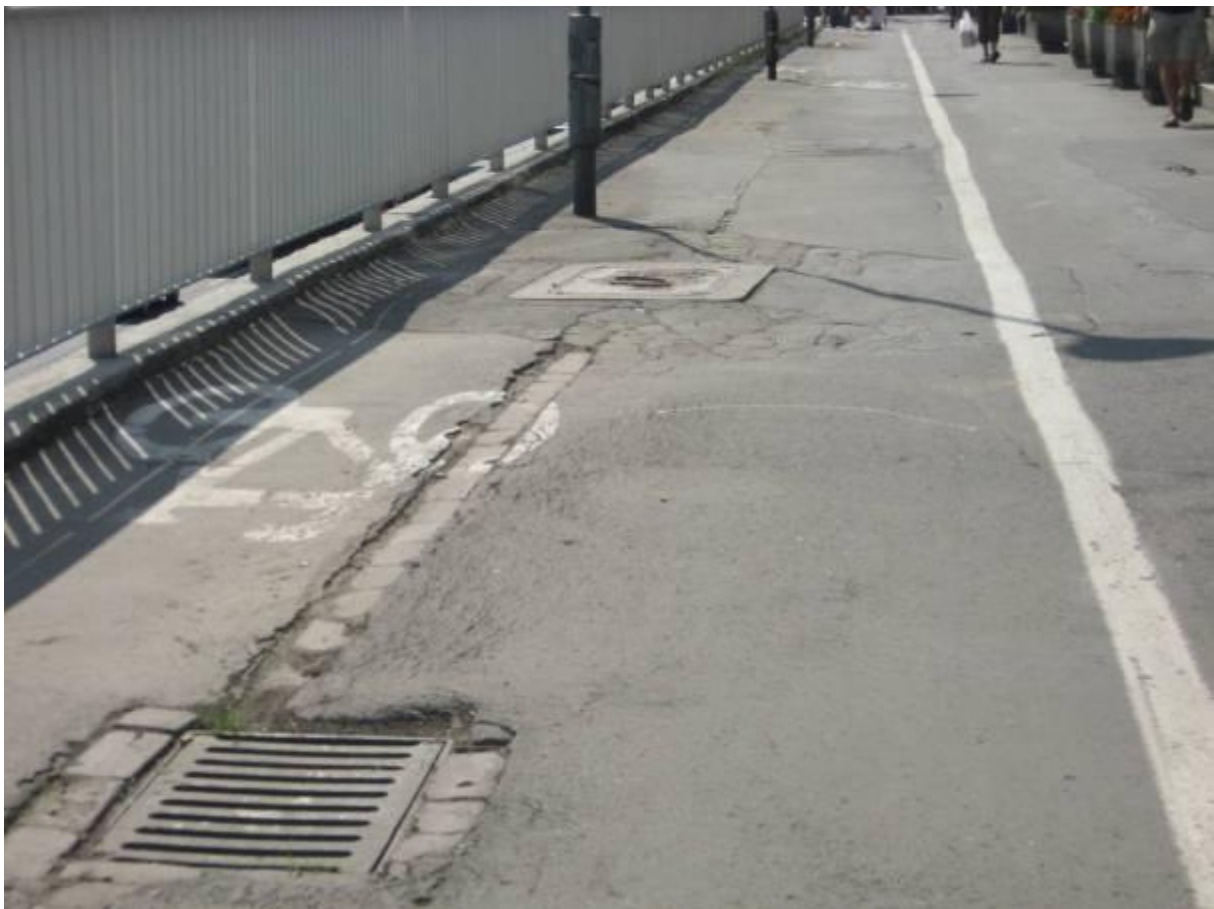
Al. Armii Ludowej pomiędzy kładką na przedłużeniu ul. Służewskiej a ul. Marszałkowską – zły stan nawierzchni i latarnie utrudniające ruch po drodze dla rowerów.
