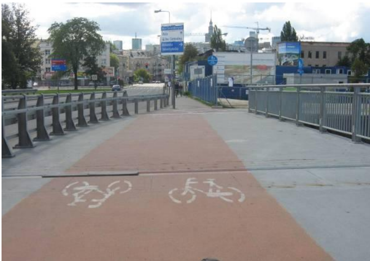
Most Świętokrzyski/ul. Wybrzeże Kościuszkowskie – trasa 2. Niezabezpieczona szczelina dylatacyjna przykryta po lewej stronie deską (najprawdopodobniej przez rowerzystów).
