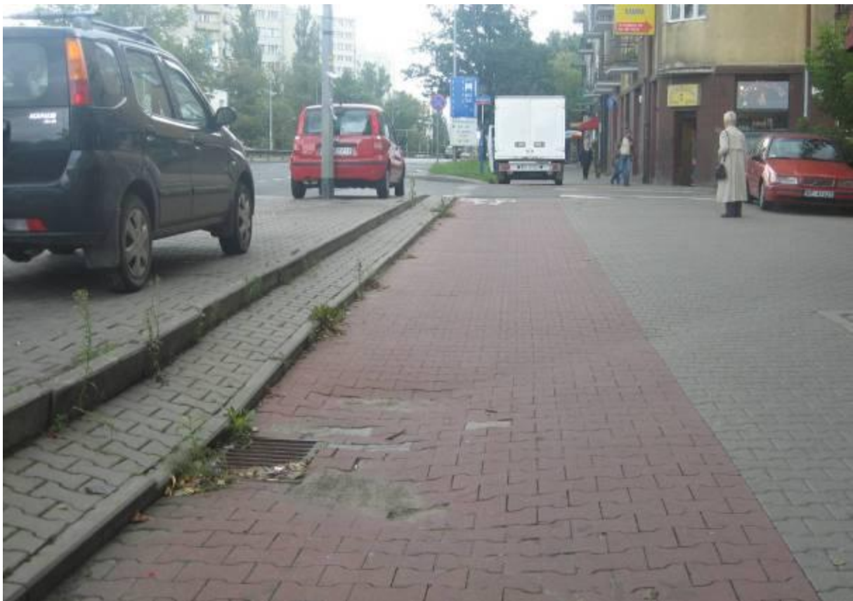
Ul. Sobieskiego – trasa 3. Nierówności nawierzchni drogi dla rowerów i parkująca na niej ciężarówka.
