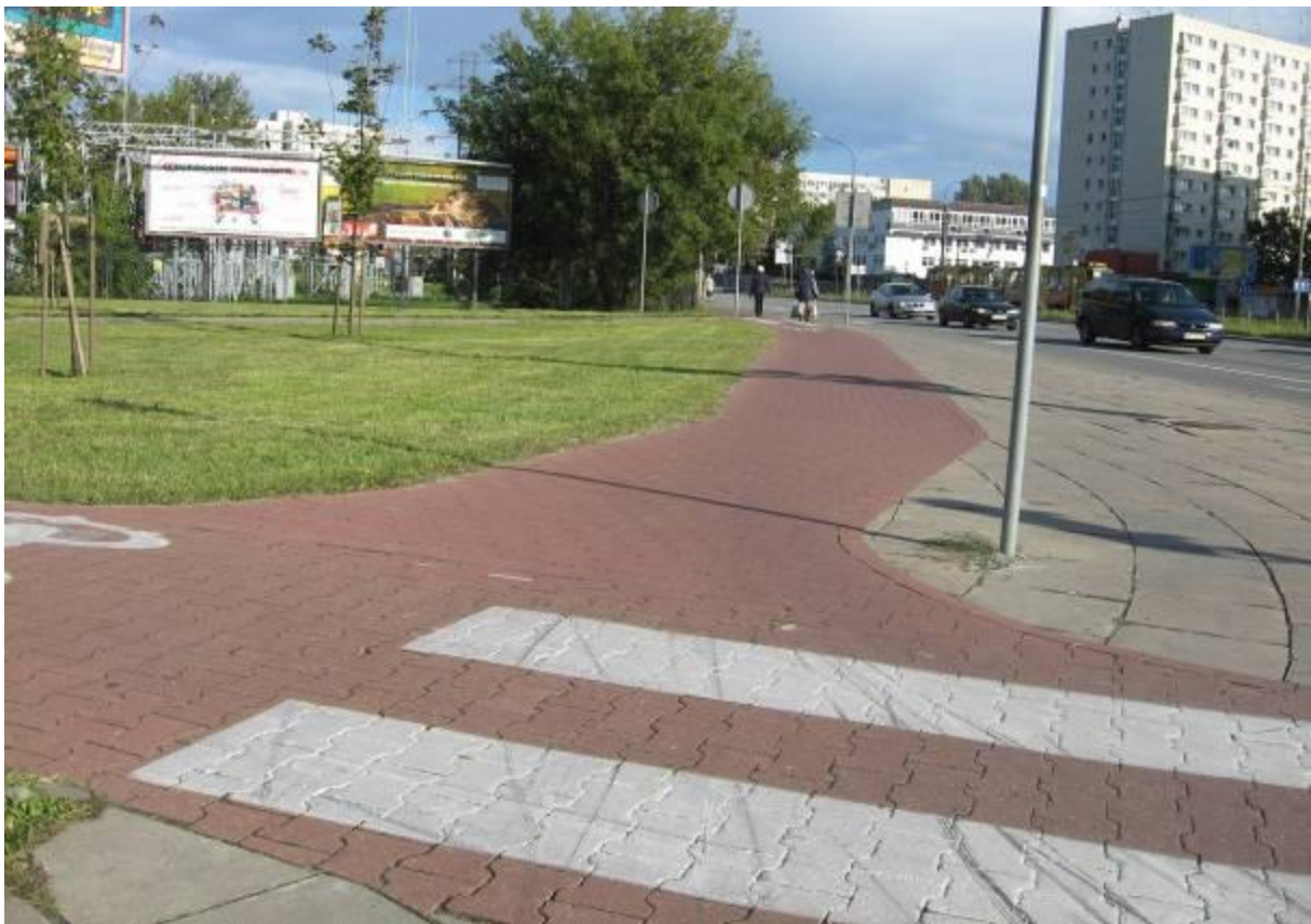
Ul. Broniewskiego/Trasa Armii Krajowej- za mały promień łuku przy skęćie w prawo oraz sztyca znaku drogowego ustawiona w sposób uniemożliwiający złagodzenie zakrętu.
