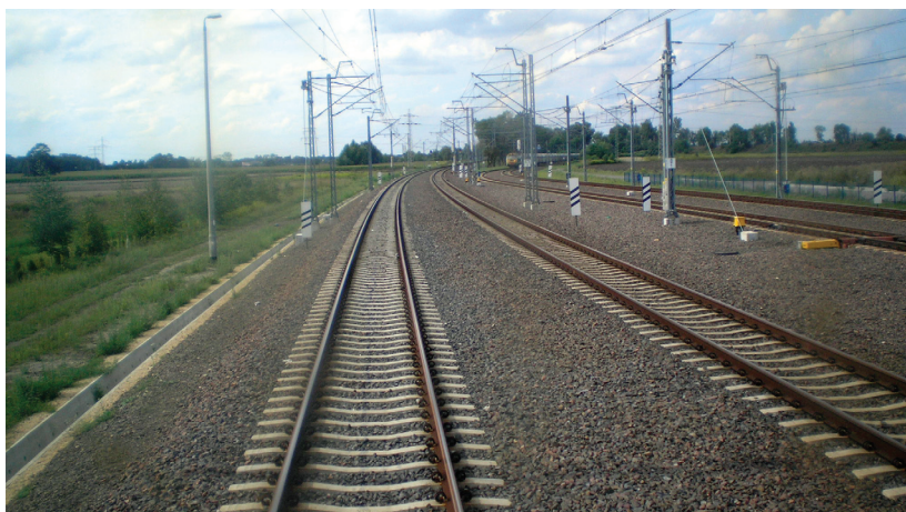
Fot. 1. Dokonana kosztem setek milionów złotych i ośmiu lat dezorganizacji ruchu modernizacja linii E30 Wrocław - Opole nie przyniosła widocznych rezultatów: odcinek Brzeg - Opole pociągi osobowe pokonują w takim samym czasie jak przed remontem.
