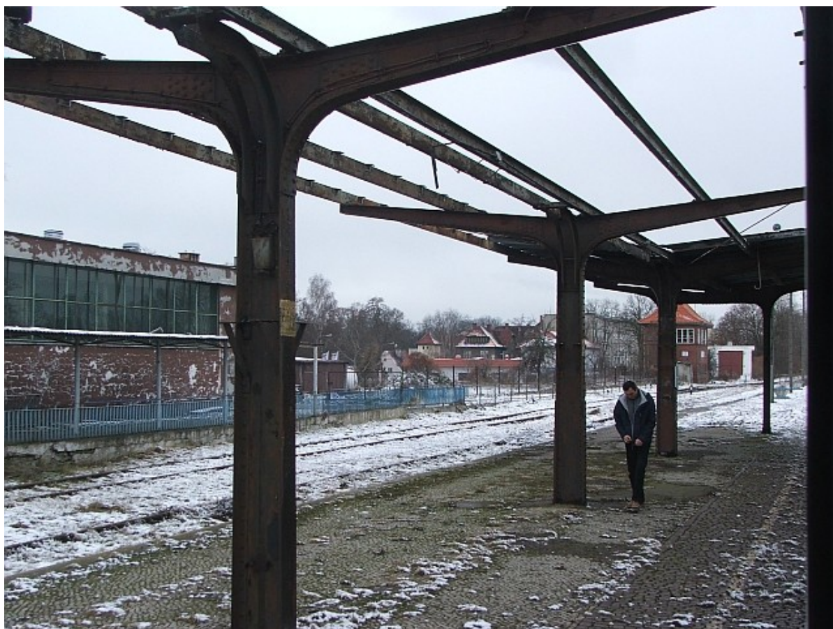
Zdjęcie 11. Opłakany stan tutejszej infrastruktury kolejowej – peron na dworcu w Szprotawie. 26.11. 2007, g.12:37 (zdj. Marcin Maciąg)
